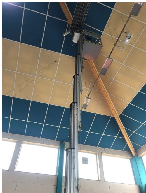
Contrôle chauffage salle basket
